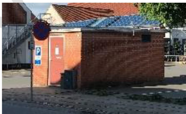
Billede af transformatorstationen på parkeringspladsen
